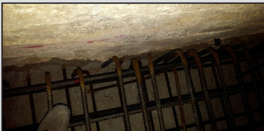
تصویر شماره (۴) عدم رعایت کاوربتنی میلگردها در فنداسیون
