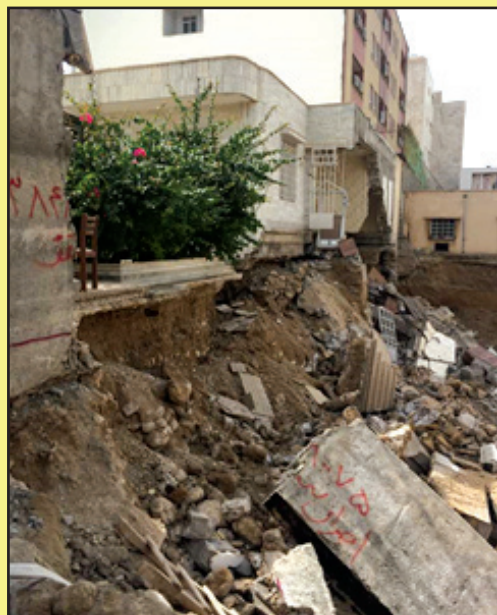
شکل ۳: تخریب بخشی از ساختمان مجاور ضلع شرقی
