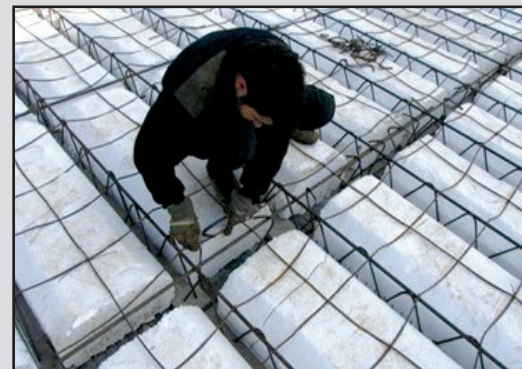
تصویر شماره (۸) عدم رعایت کاوربتنی میلگردهای حرارتی سقف
