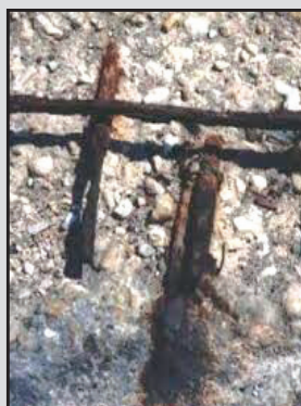
تصویر شماره (۱۱) پیشرفت فرایند خوردگی شیمیایی در یک فنداسیون بتن آرمه
