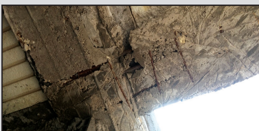
تصویر شماره (۶) عدم رعایت کاوربتنی میلگردها در تیرهای بتن آرمه سقف
