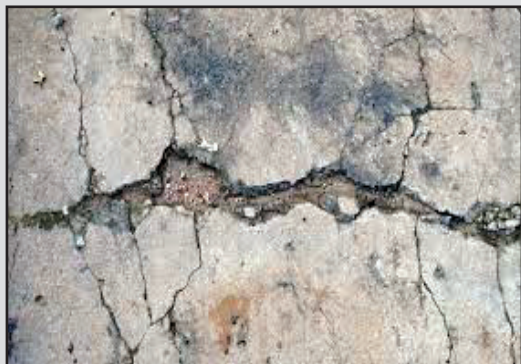
تصویر شماره (۱۲) ترک خوردن نازک کاری و پوشش بتنی در یک تیر بتن آرمه ناشی از عدم رعایت حداقل ضخامت پوشش بتنی
