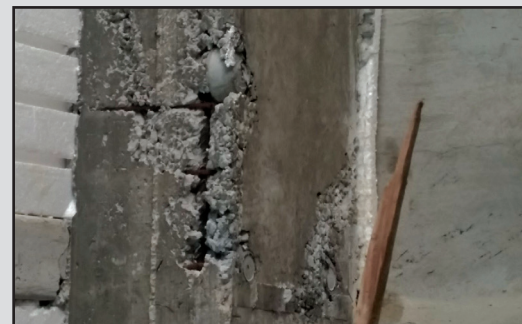
تصویر شماره (۹) عدم رعایت کاوربتنی میلگردها در تیرهای بتن آرمه سقف
