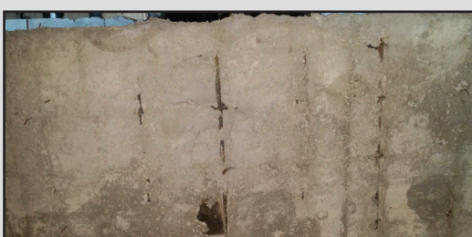
تصویر شماره (۷) عدم رعایت کاوربتنی میلگردها در شمشیری راه پله بتنی
