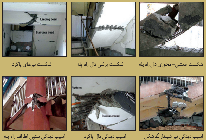
شکل ۱: آسیب دیدگی اجزای راه پله در زمین لرزه (Bixiong و همکاران، ۲۰۰۸)
